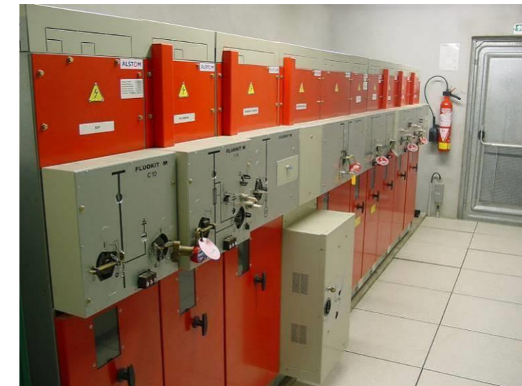
Illustration 7 : Intérieur d'un poste de livraison
